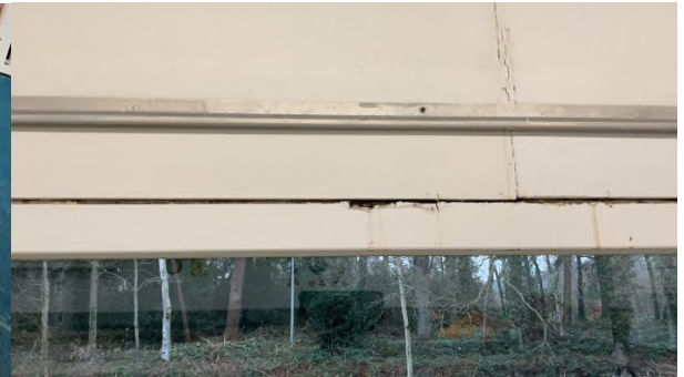
Afb. 6 – Houtrot houten kozijnen zwemzaal
